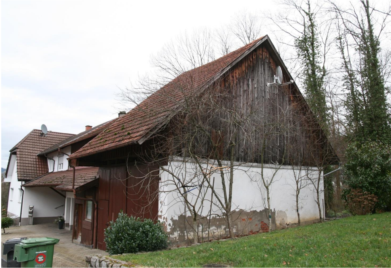
Abb. 3: Giebelbereich und Fassade des Gebäudes Kammsbosch 1; das zum Abriss vorgesehene Ökonomiegebäude im Vordergrund
